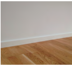
Vit, slät listverken har synlig infästning, fabriksmålade
