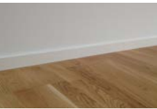
Vit, slät Listverken har synlig infästning, fabriksmålade
