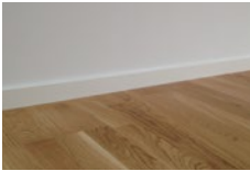
Vit, slät Listverken har synlig infästning, fabriksmålade
