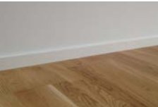
Vit, slät Listverken har synlig infästning, fabriksmålade
