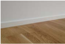
Vit, slät Listverken har synlig infästning, fabriksmålade
