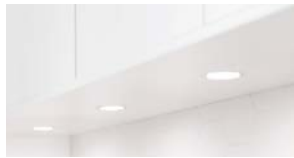
Infällda LED-spotlights i belysningsbotten/dekorskiva inklusive dimmer
