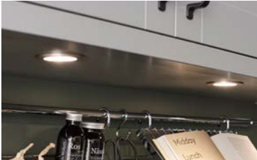
Spotlights LED, rund Infällda spotlights under överskåp
