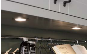
Spotlights LED, rund Infällda spotlights under överskåp
