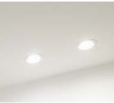
Infällda spotlights Nedpendlat undertak med dimmer. Observera att val medför cirka 10 cm lägre rumshöjd i lägenheter där det inte redan finns ett undertak att fälla in i.
