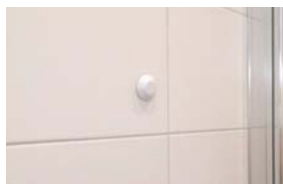
Förberett för handdukstork som ej ingår. Kanalisation pluggas med lock/plugg för att möjliggöra framtida installation av handdukstork.
